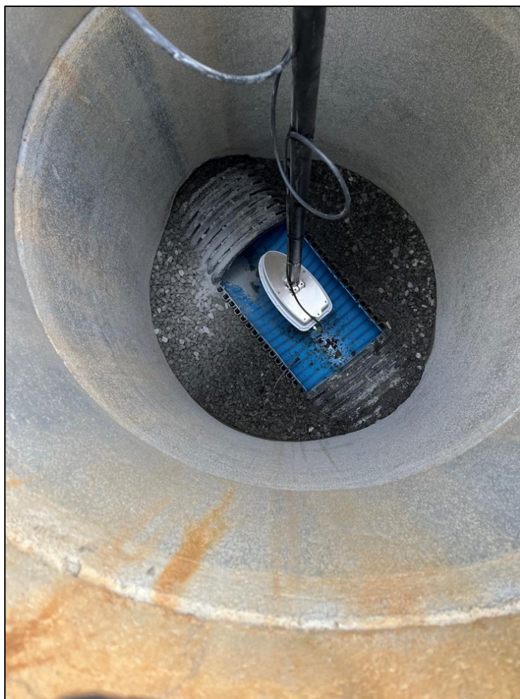
Figur 2-8. Foto av radarmåling som er installert over det midlertidige røret som er lagt for Maurtubekken (bilde fra NIBIO, 19. april 2024).
